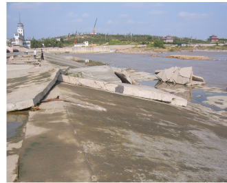
图3 一级消力池下游破坏情况
