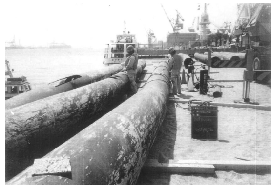
图5 Takahama 码头的桩基破坏
